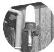
訪問先で不良の照明器具を改修指導
