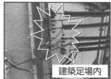
<引込線縁廻り防護なし>
