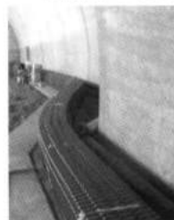
トンネル内配管
