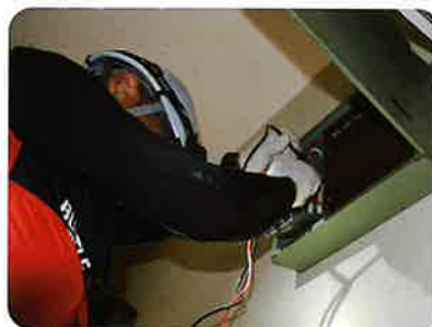
▲ 絶縁抵抗測定の様子
