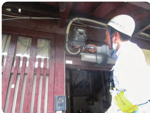
▲訪問住戸漏洩電流計にて測定
